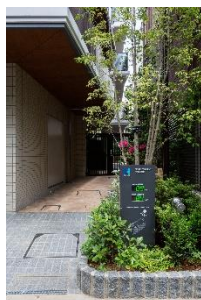
太陽光パネル表示板
