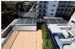
屋上太陽光発電
