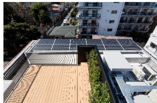
屋上太陽光発電
