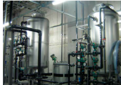
地下鉄湧出水濾過装置設置状況(御茶ノ水ソラシティ)
